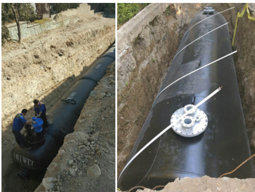
شکل ۳-۹. نمونه مخزن کمکی اجرا شده در تهران (سمت راست: مخزن چند داکتیل محله زرگنده، سمت چپ: مخزن فولادی پارک شهر در منطقه ۴ آبفای تهران)
